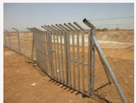
家畜の侵入を防ぐための堤防・フェンス
