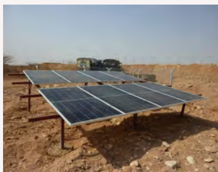
浄水や水のくみ上げのためのソーラーパネル
