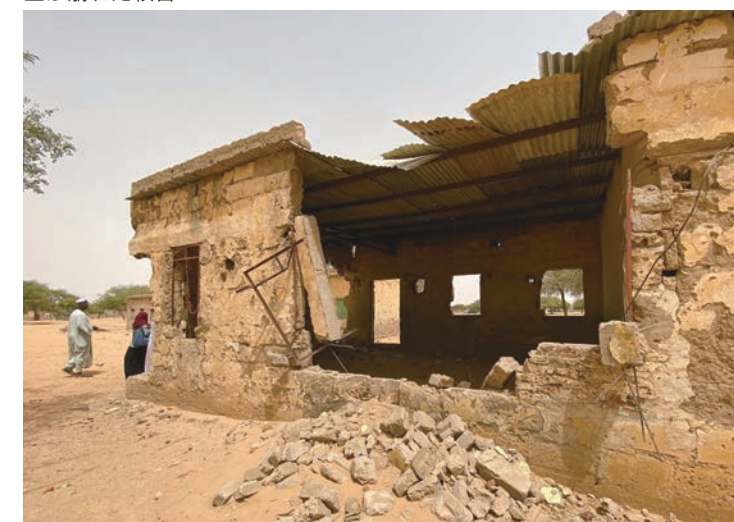
壁が崩れた校舎
